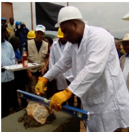
Pose de la 1ère pierre pour la construction du laboratoire moderne du SENASEM à Emilingombe
